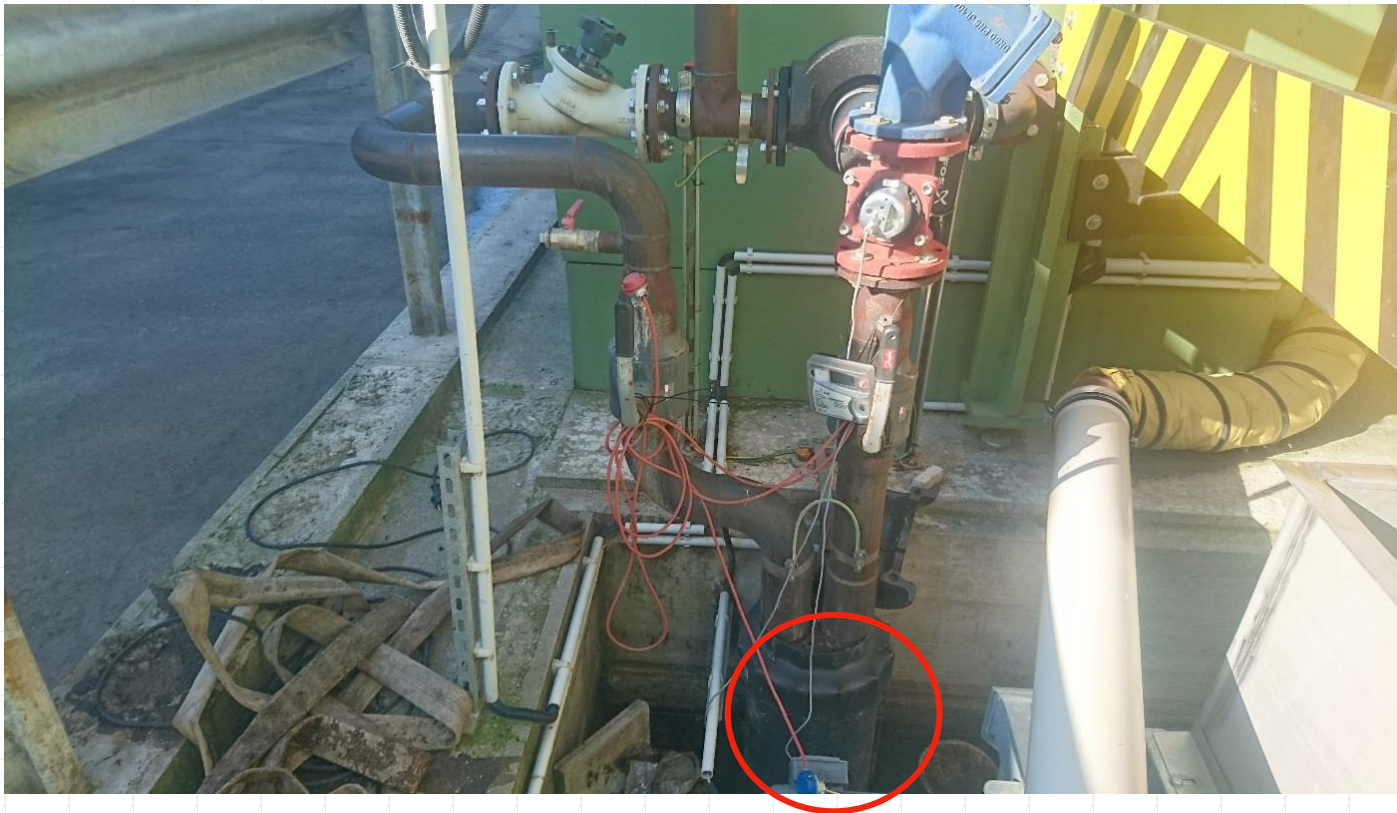
WMZ an Gärrestetrockner Rücklauffühler ausgebaut
