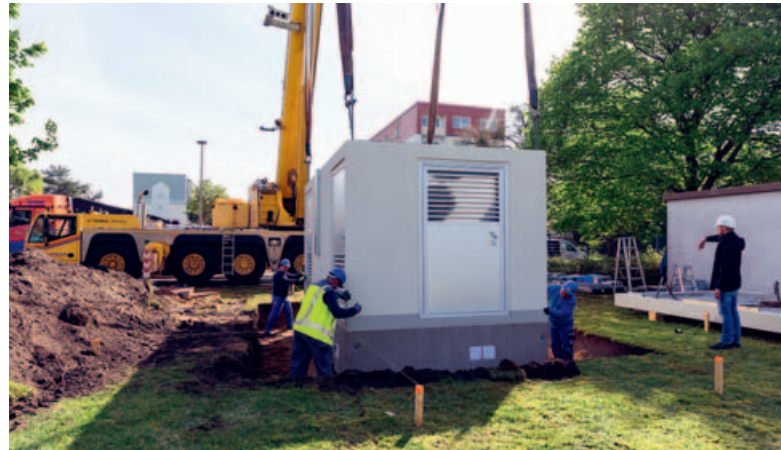
Anlieferung der Batteriespeicherstation WBS 500 in Neustadt-Glewe
