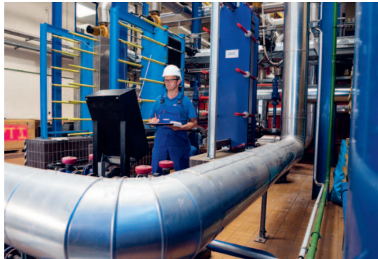
Geothermiekraftwerk in Neustadt-Glewe
