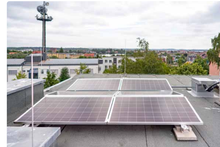
Auch auf dem WEMAG-Gebäude erzeugt eine Photovoltaikanlage jeden Tag erneuerbare Energie.
